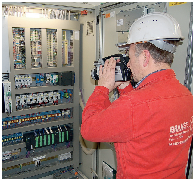
Die Elektroanlagen eines norddeutschen Chemiewerks werden im jährlichen Zyklus auf thermografische Auffälligkeiten geprüft
