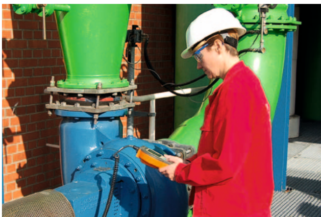
Offline-Messung: Schwingungsmessung an einer Kühlwasserpumpe mit sieben Messpunkten.
